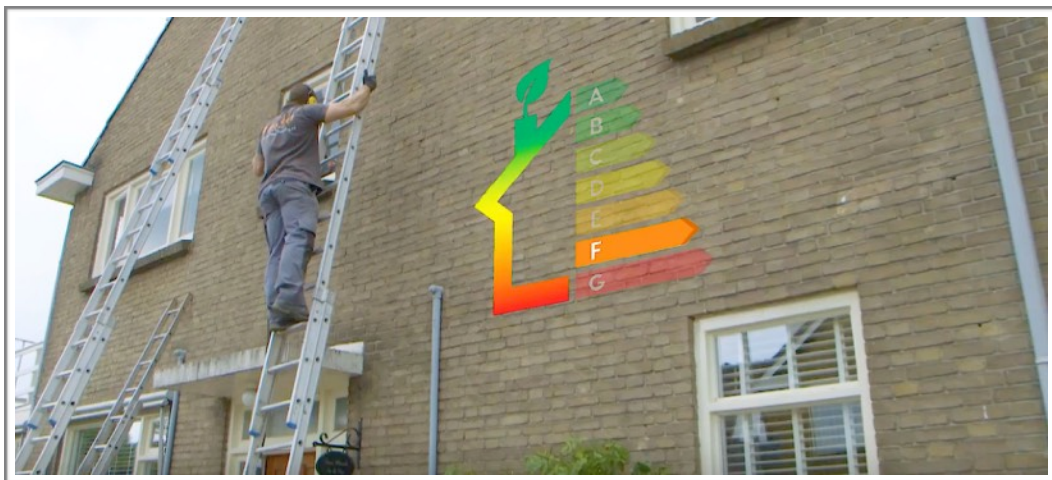
Bij spouwmuurisolatie worden kleine 'isolatiepareltjes' in de spouwmuur gespoten via een gaatjesraster van 1m x 1m. De pareltjes vormen uiteindelijk één geheel.
