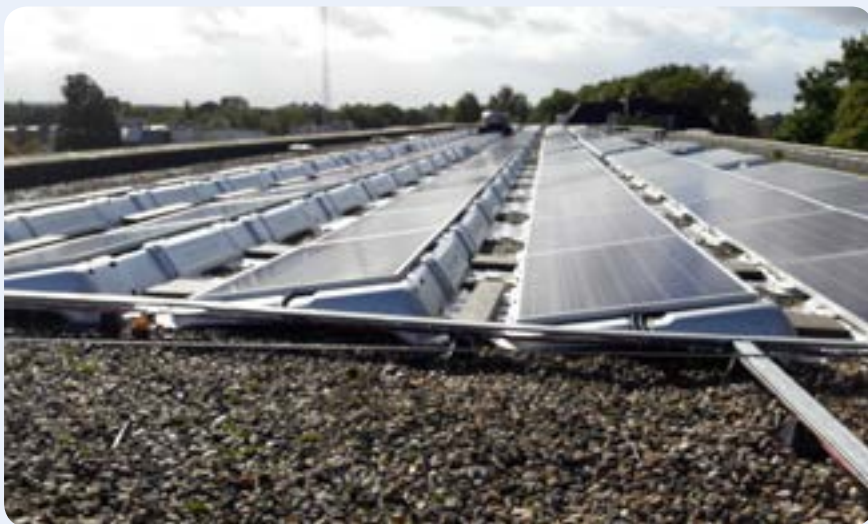
Zonnepanelen dak gemeentehuis
